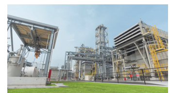
新居浜北火力発電所
